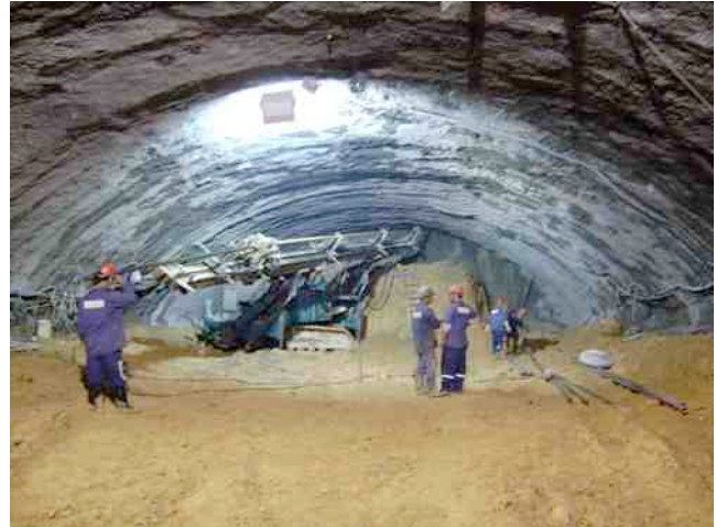
Figura 15 – Fase de escavação da Calota – Detalhe da execução de DHPv's com comprimento de 15,0m.
